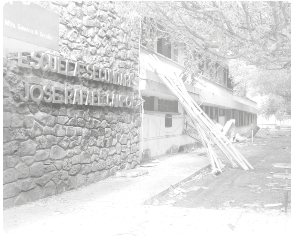
La Secundaria José Rafael Campoy con 83 años de ser fundada así como la Escuela Primaria Recursos Hidráulicos, comenzaron a ser derrumbadas debido a los daños que sufrieron durante el sismo del año pasado.
